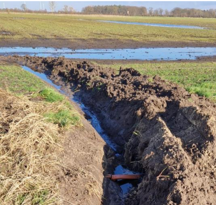
© DNS:NET Internet Service GmbH Der Leitungsschaden an dem Glasfasernetz ist deutlich zu erkennen.
